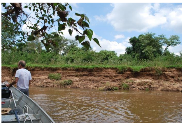
Figura 3.31 – Erosão nas margens do Rio Corumbataí, no município de Rio Claro
