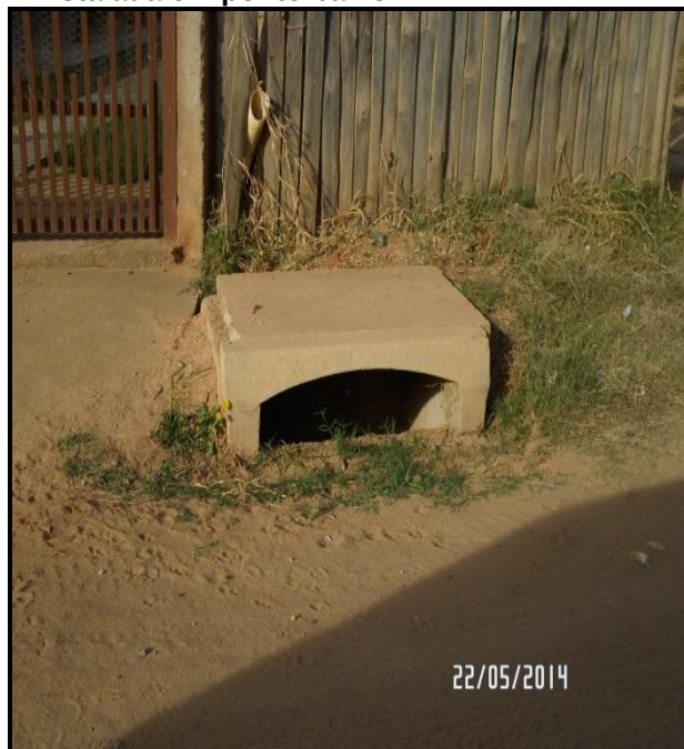
Figura 100 - Vista de uma Boca-de-lobo instalada em ponto baixo
