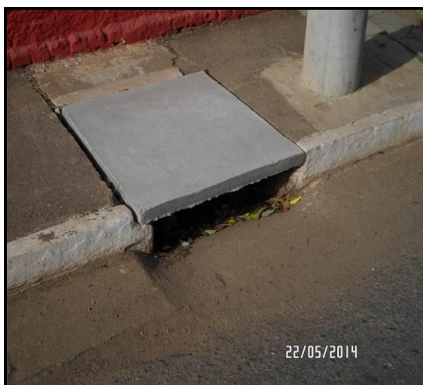
Figura 94 - Vista de uma Boca-de-lobo localizada, no entanto sem grelha
