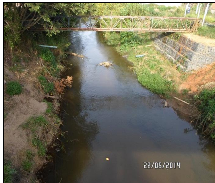
Figura 76 - Vista de cima da ponte sobre o Rio Sapucaí. Nota-se as margens em processo de erosão o que resulta em assoreamento do rio
