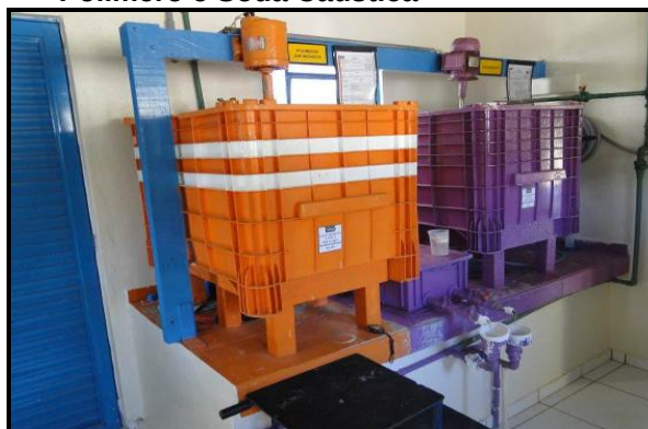
Figura 49 - Dosagem de Produtos Químicos - Polímero e Soda Cáustica
