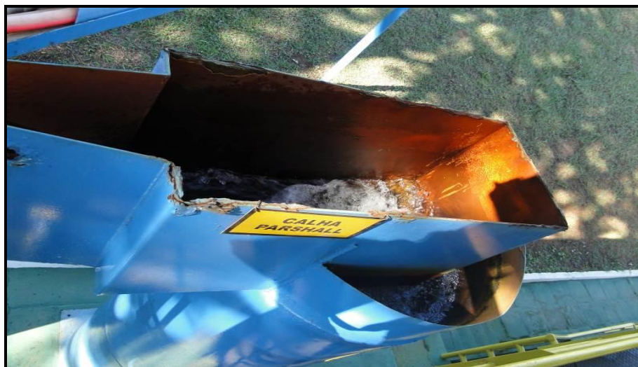
Figura 44 - Mistura Rápida - Calha Parshall na chegada da ETA
