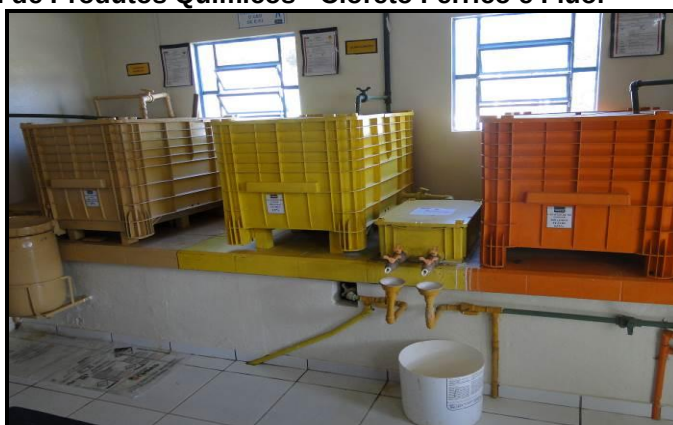
Figura 50 - Dosagem de Produtos Químicos - Cloreto Férrico e Flúor
