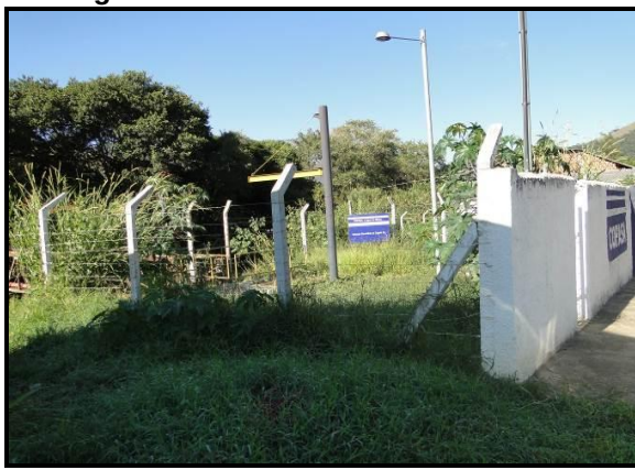
Figura 57 - Estação Elevatória de Esgoto 2
