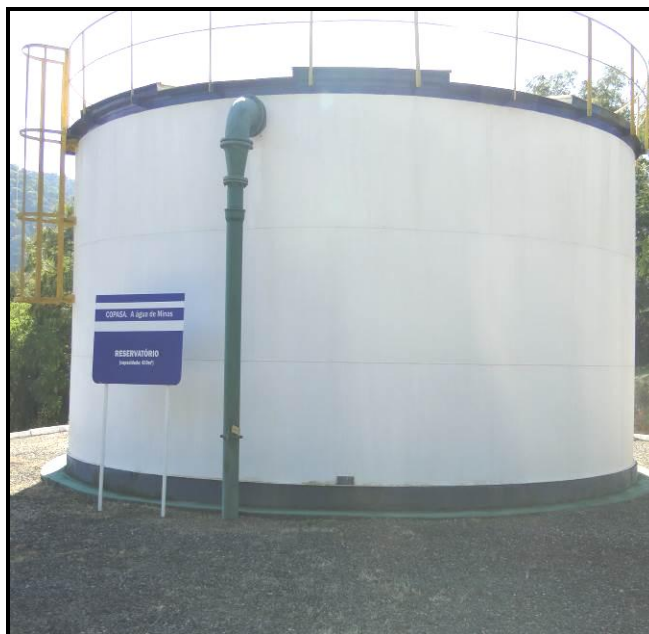
Figura 53 - Reservatório R1 - ETA - Capacidade: 420 m³
