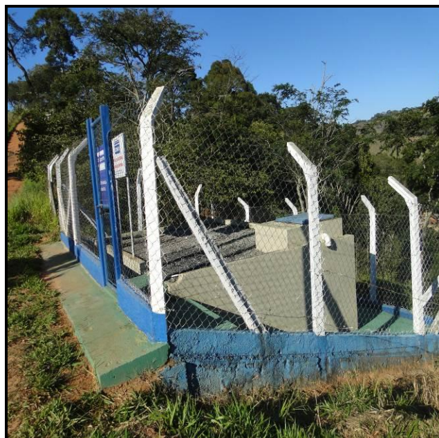
Figura 54 - Reservatório R2 - Florada da Serra - Capacidade: 30 m³
