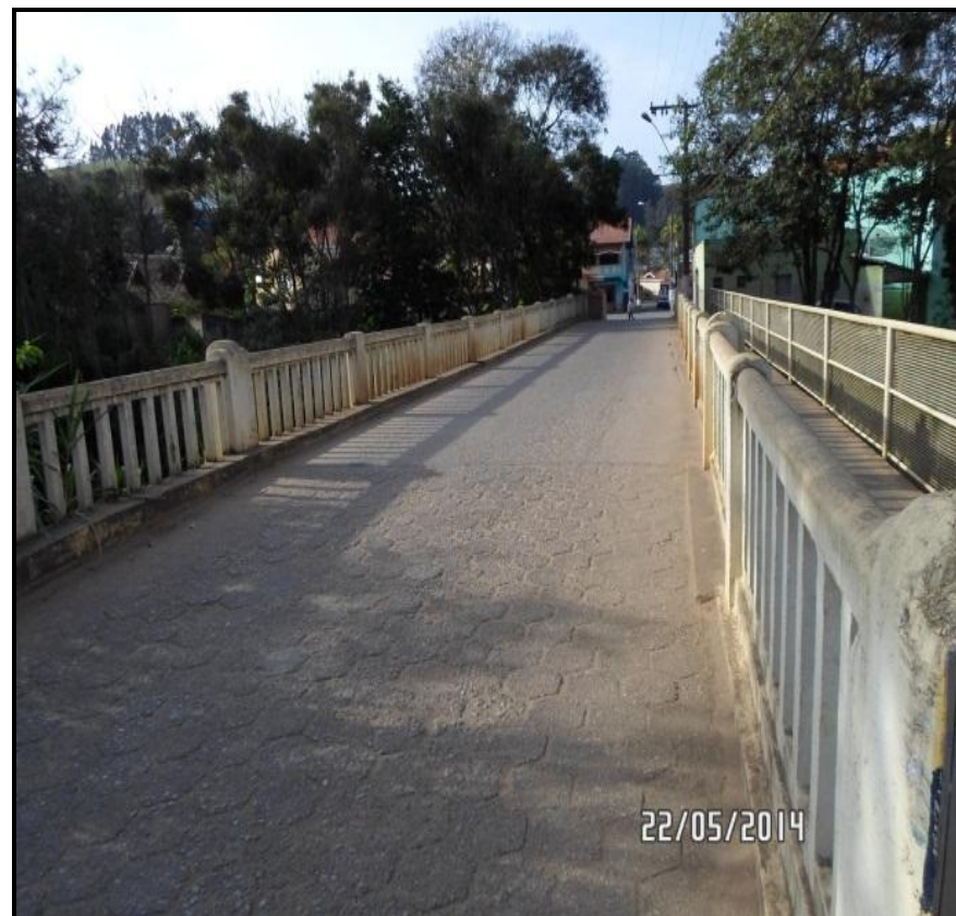
Figura 78 - Vista das condições da ponte sobre o Rio Sapucaí
