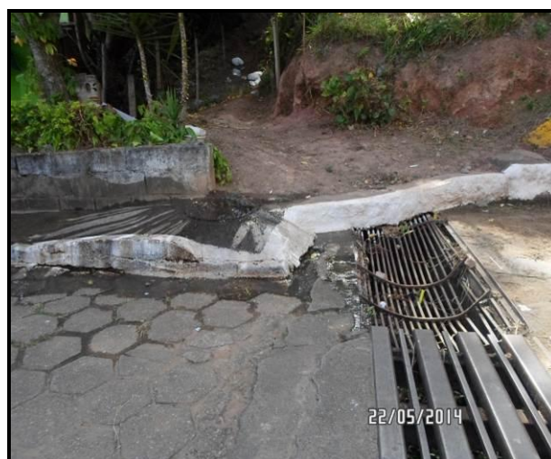
Figura 106 - Nota-se um vazamento em um Posto de Visita de esgoto despejando diretamente na rede de água pluvial
