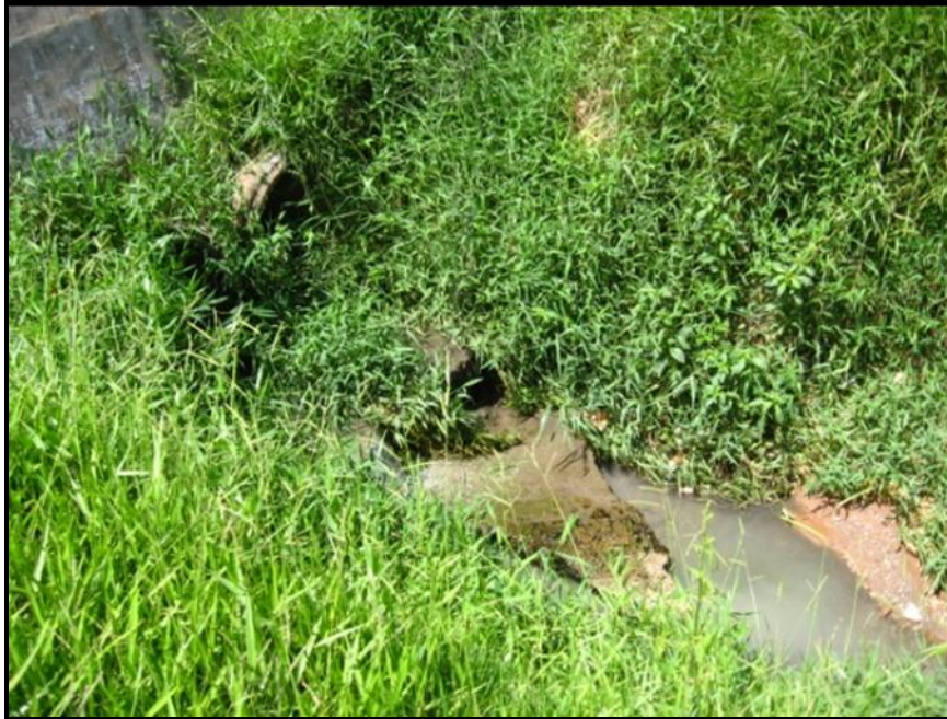
Figura 82 - Vista do canal obstruído por sedimentos e a má conservação do trecho
