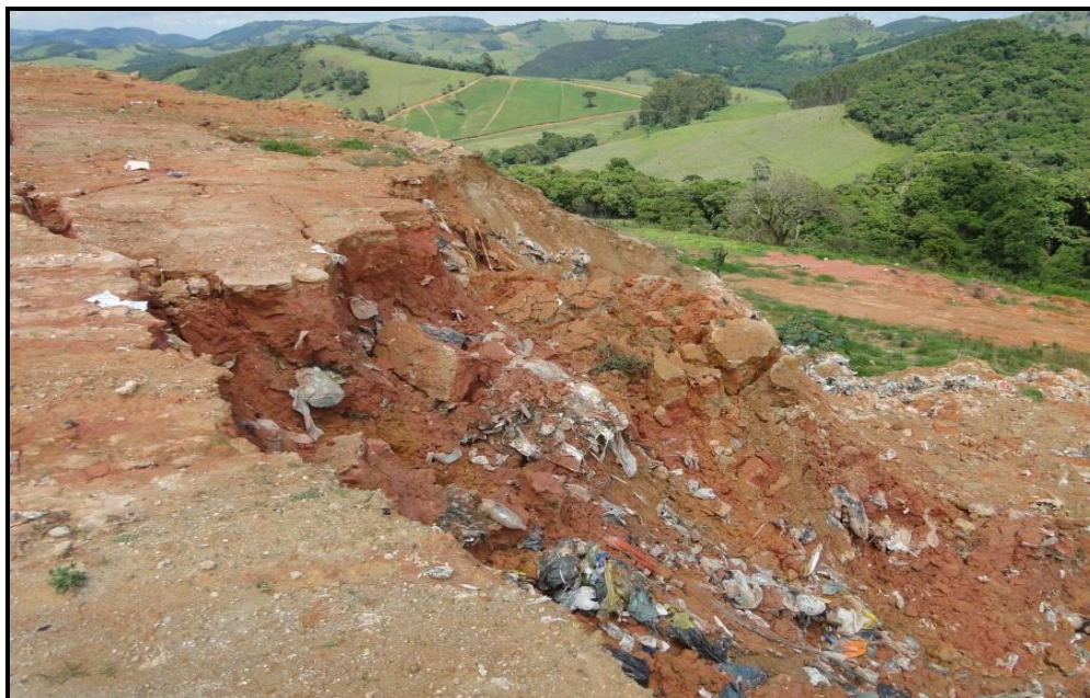
Figura 45 - Talude em processo de desmoronamento
