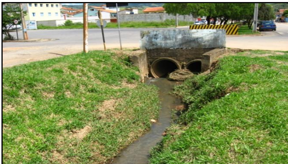
Figura 81 - Vista das aduelas obstruídas por sedimentos
