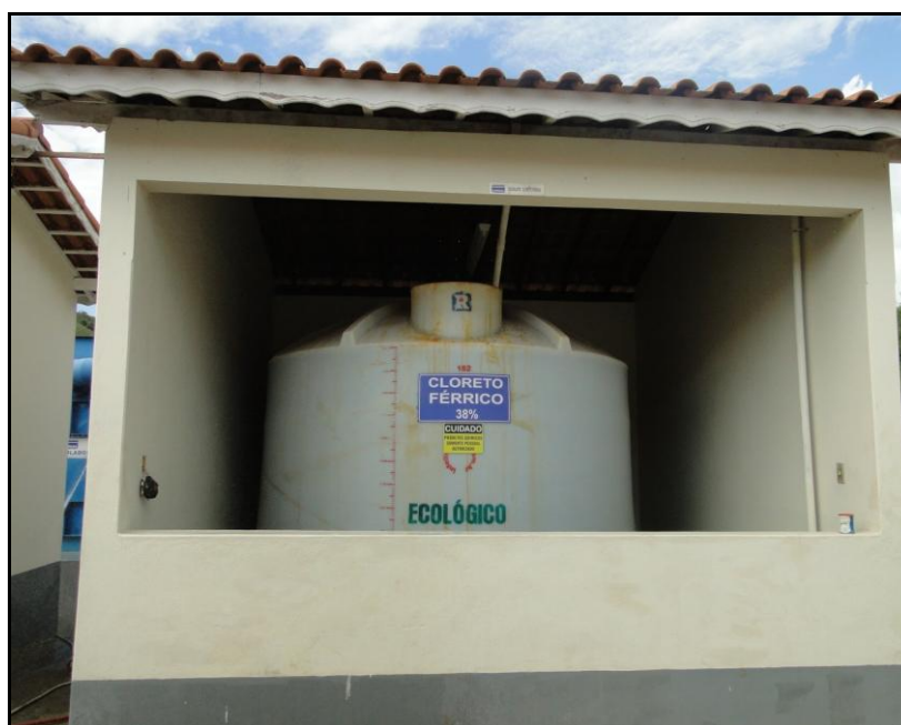
Figura 39 - Armazenamento de Produtos Químicos
