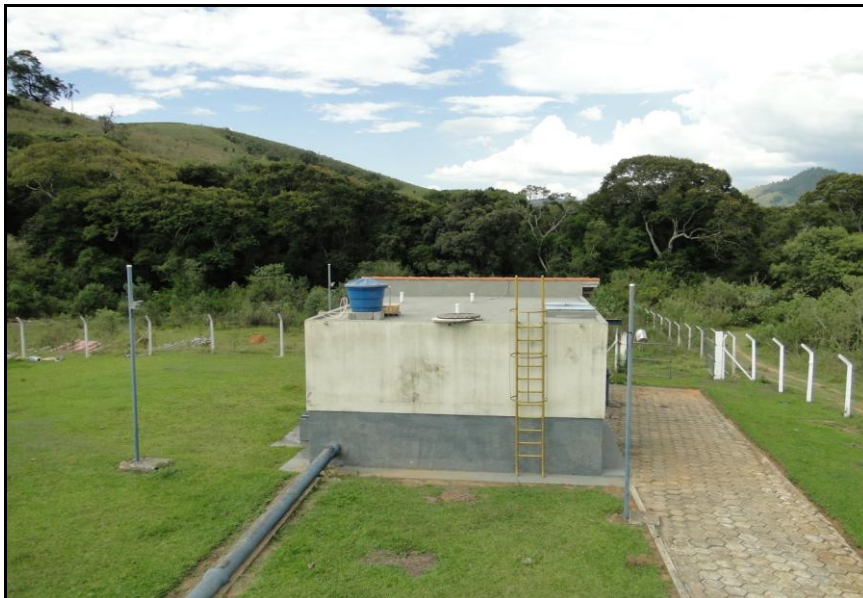
Figura 38 - Tanque de contato
