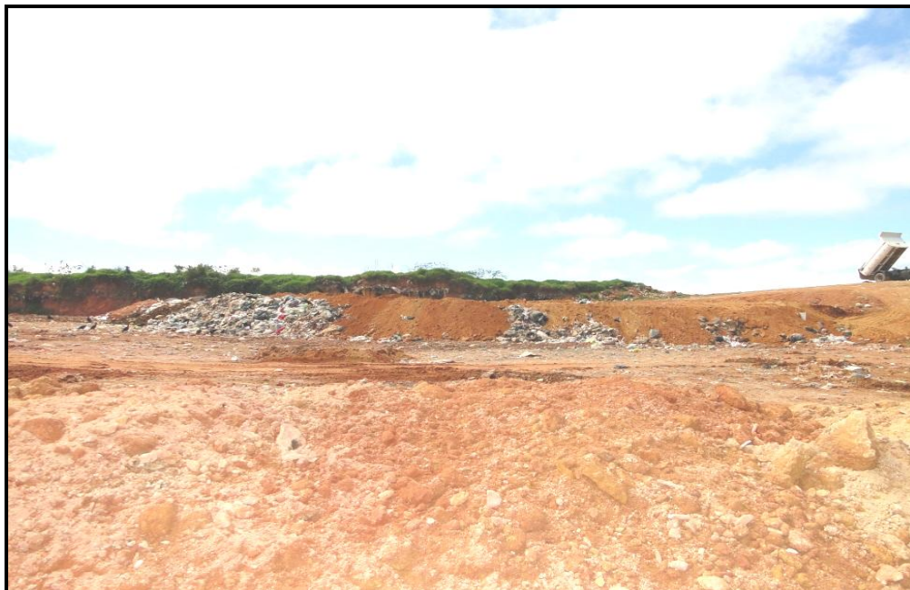
Figura 44 - Resíduos depositados, sem compactação apenas coberto com terra
