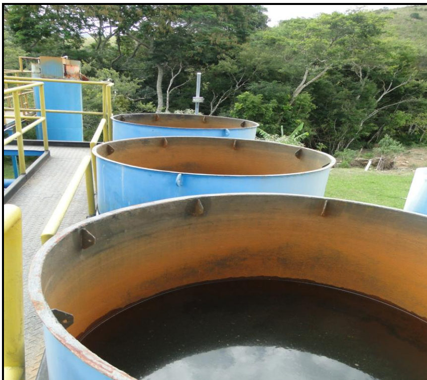
Figura 37 - Filtros da ETA
