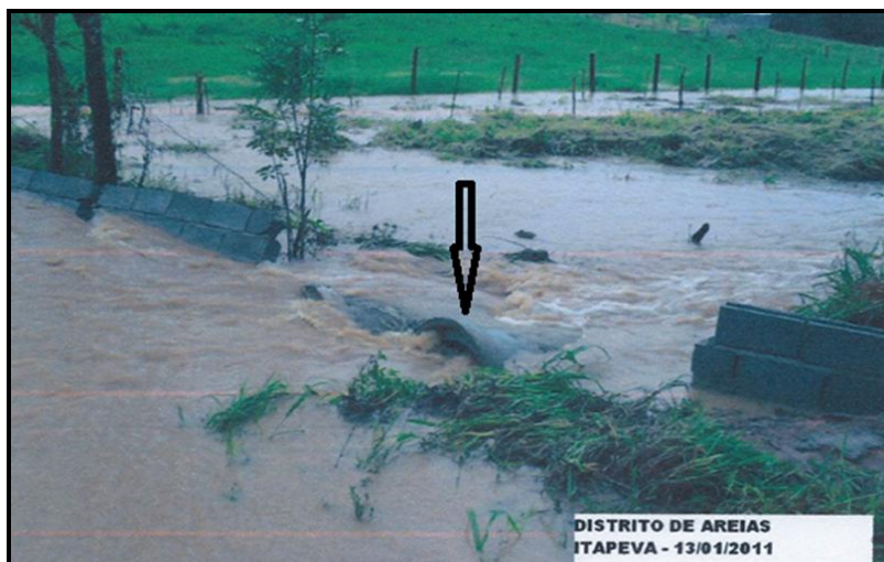
Figura 69 - Sistema hidráulico subdimensionado para evento de precipitação.
