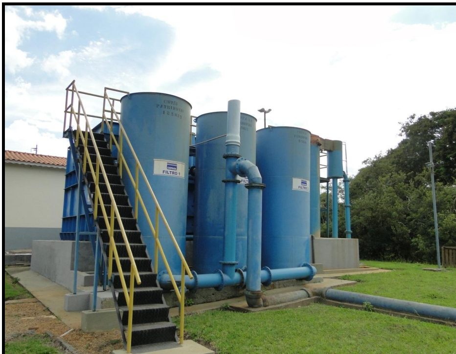
Figura 36 - Filtros da ETA
