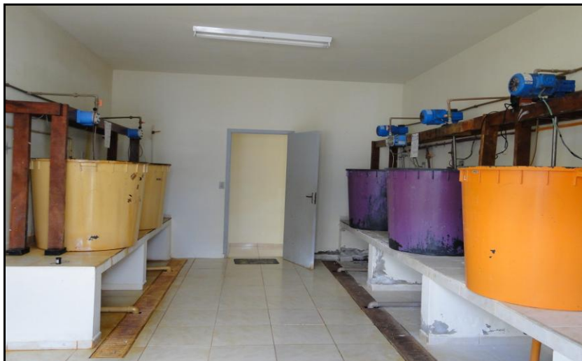
Figura 40 - Sala de preparação e dosagem de produtos químicos da ETA
