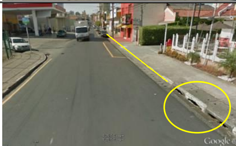
Figura 154 - Nota-se a existência de Boca de lobo tripla sem grelha
