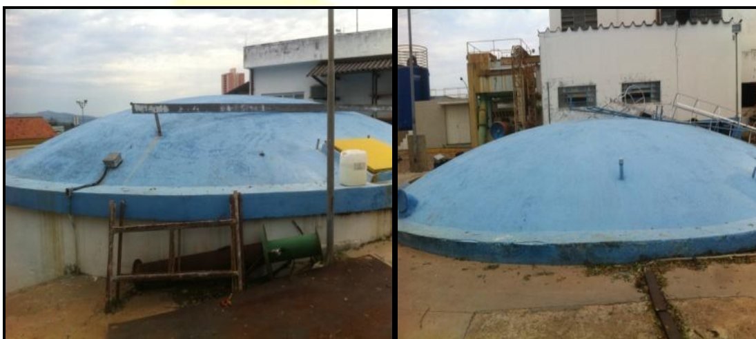
Figura 42 - Reservatórios R1 e R2
