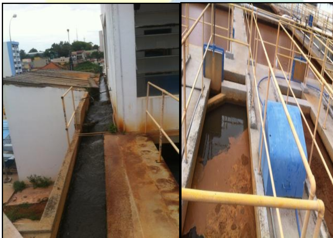
Figura 38 - Chegada água bruta e flocculadores – Módulo II
