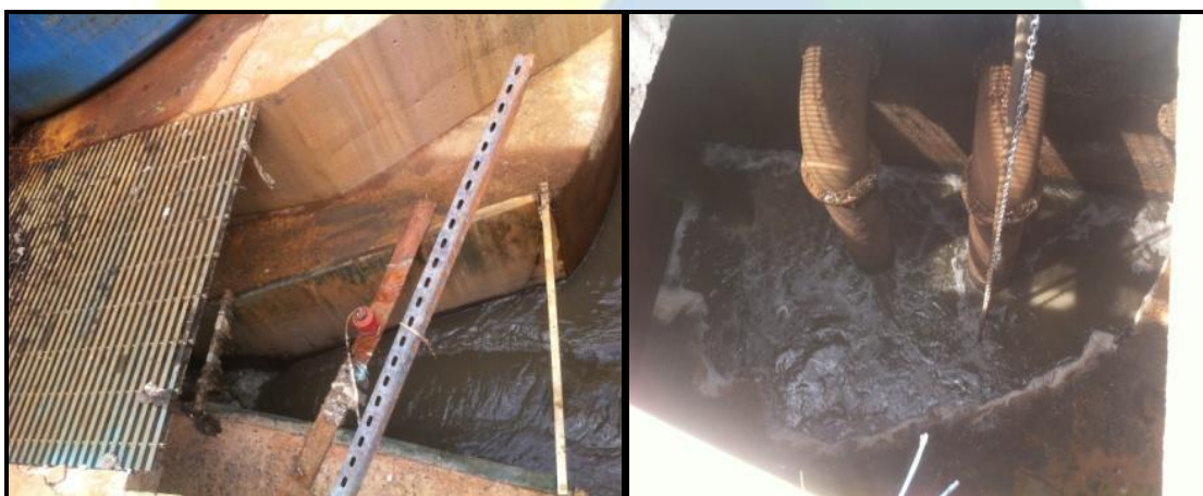
Figura 53 - Calha Parshall e tanque da elevatória de esgoto bruto
