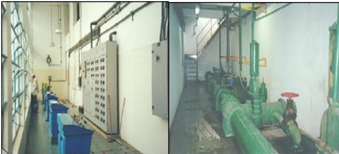
Figura 35 - Instalações da estação de tratamento de água
