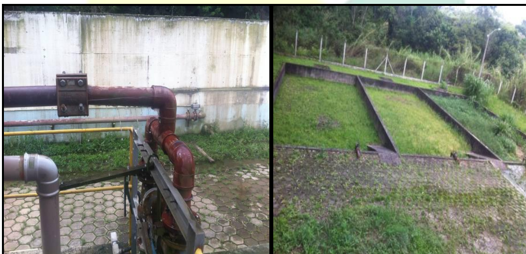
Figura 60 - Dosador de cloro e leito de secagem
