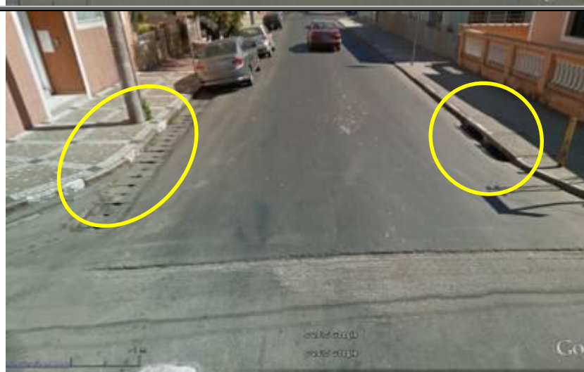
Figura 155 - Vista à direita da imagem, uma Boca de lobo sem grelha e à esquerda
