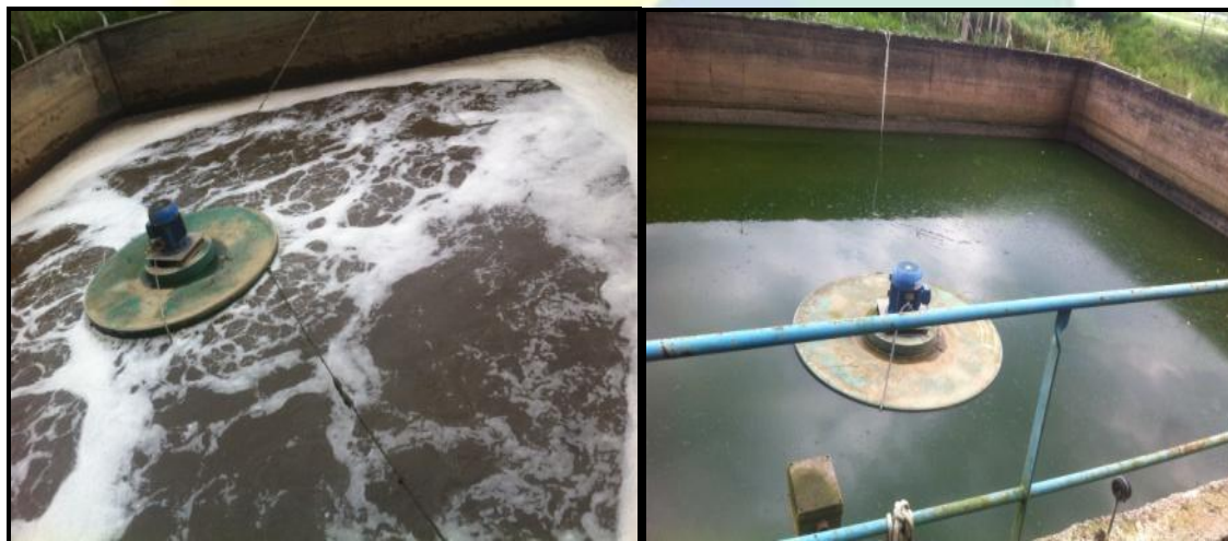
Figura 58 - Tanques de aeração
