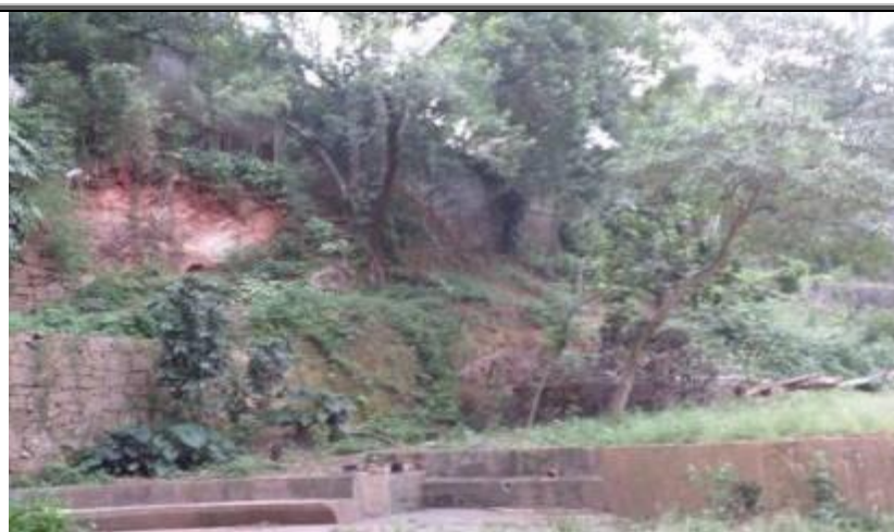
Figura 185 - Evidências de deslizamentos ocorridos devido à falta de conservação da encosta
