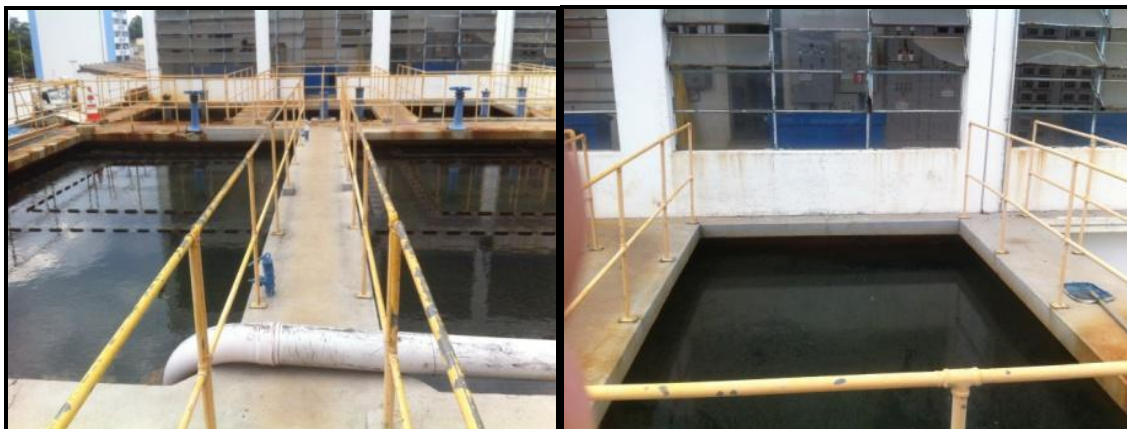
Figura 39 - Decantadores e filtros – Módulo II
