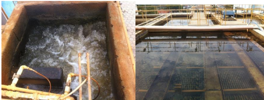
Figura 37 - Chegada água bruta, flocculadores e decantadores – Módulo I
