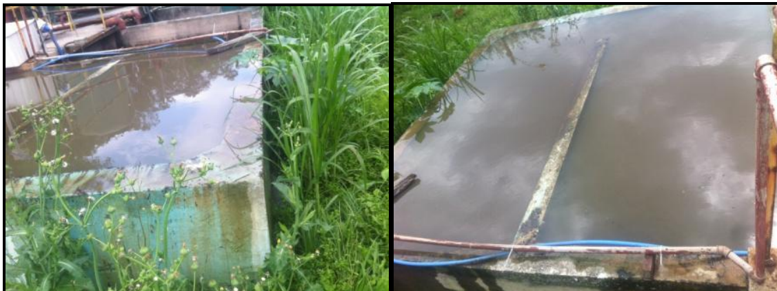
Figura 59 - Tanques de dosagem de cloro
