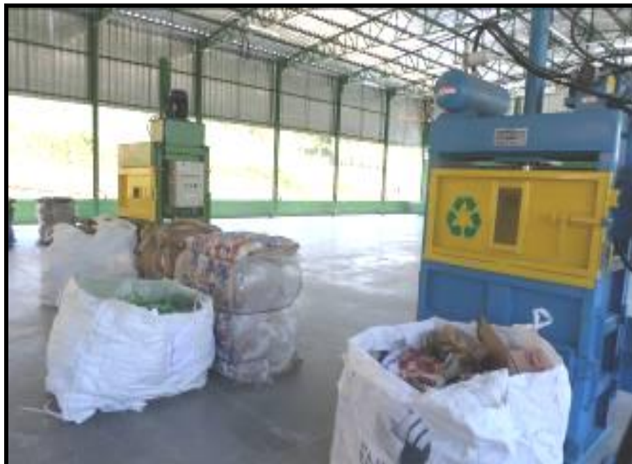
Figura 74 - Vista das prensas mecânicas para enfardamento e expedição
