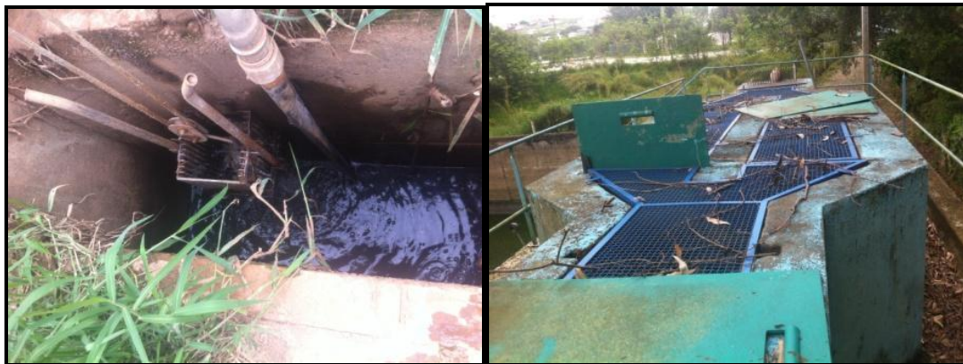
Figura 57 - Chegada do efluente e gradeamento
