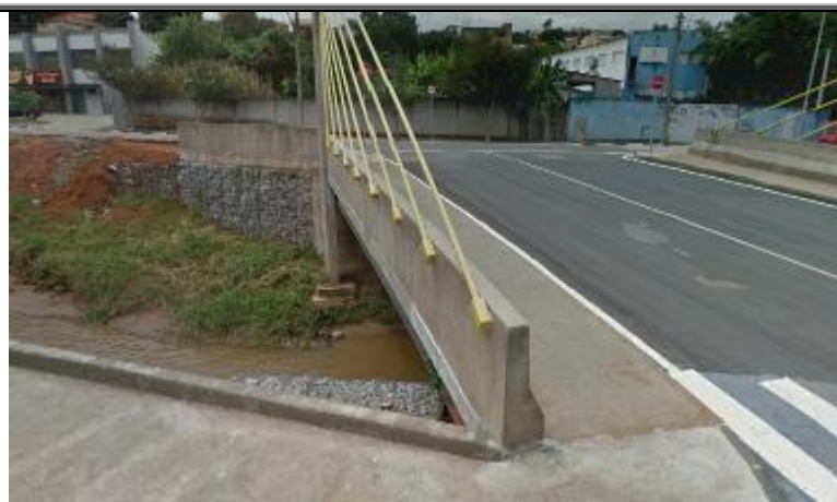
Figura 126 - Vista a jusante das condições da ponte da Travessa Olivio Tegen.
