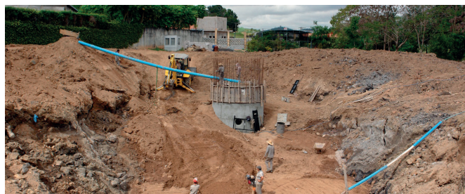
Estação elevatória Marambaia - Sanebavi Vinhedo - Foto: Jean Spaduzano
