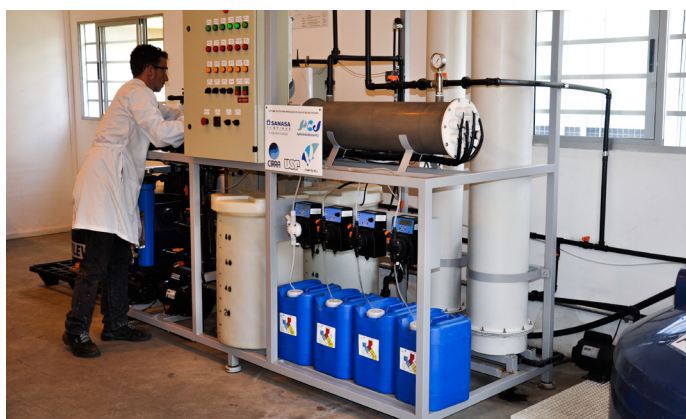
Módulo de tratamento na EPAR Capivari II
